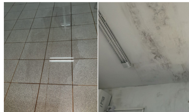
Demora para reparar piso rachado e infiltração em Maravilha se assemelha à demora para reparar infiltrações e mofo no escritório da Celesc de Tijucas
